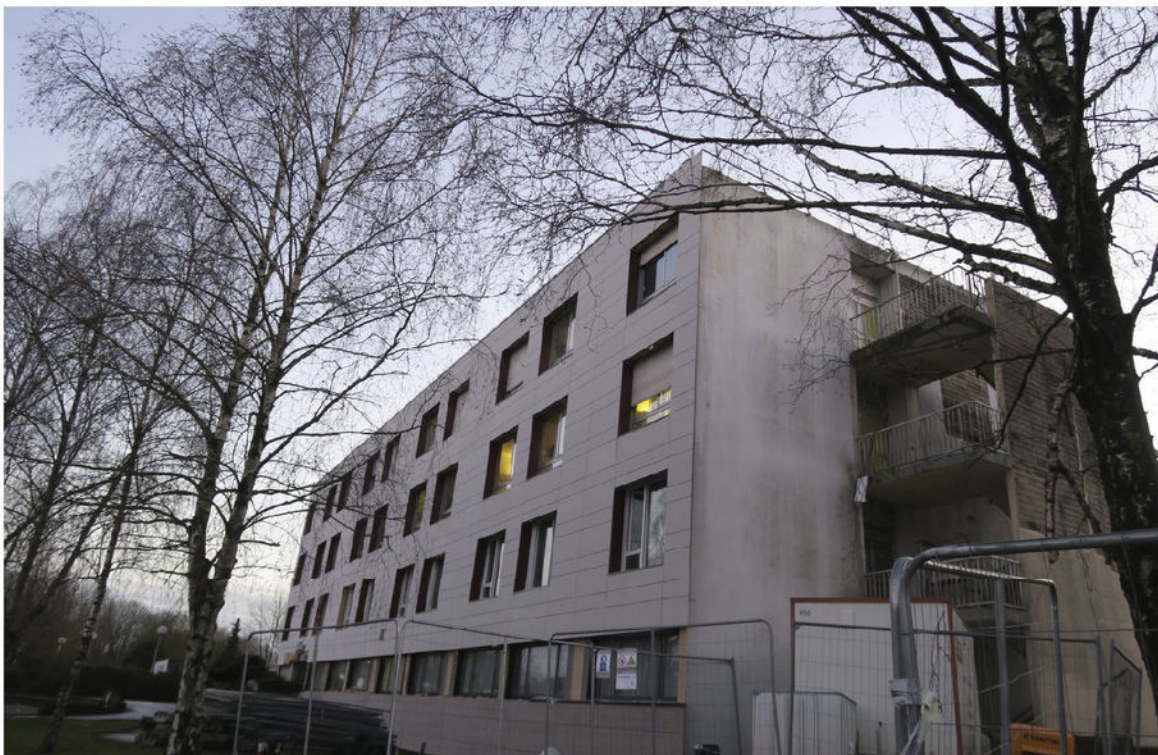
La réhabilitation du bâtiment Les Chênes a démarré. Le chantier a toutefois été retardé par des travaux de désamiantage.
